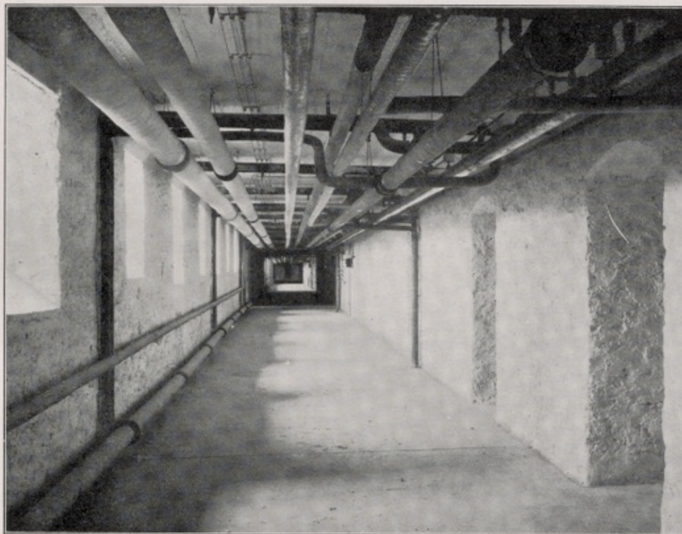
Leitungen im Keller der chirurgischen Abteilung.
